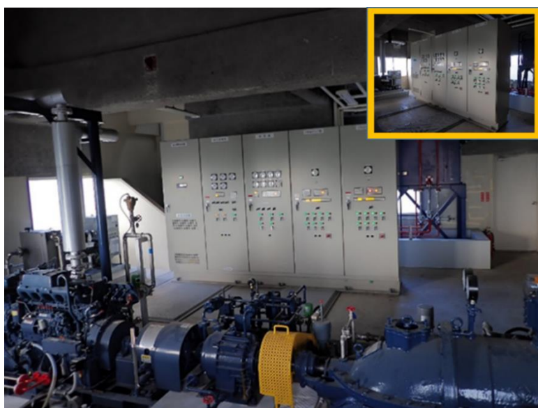
▲ 水処理設備での制御システム導入
