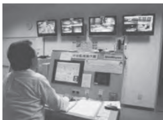
(2) 中央監視操作室
