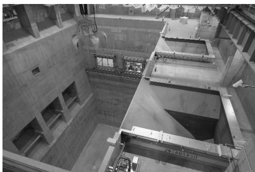
ごみクレーン
