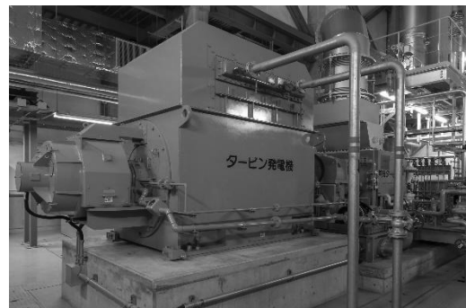
蒸気タービン
