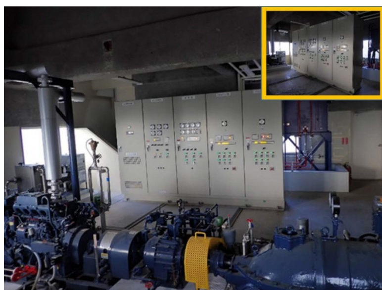
▲ 水処理設備での制御システム導入
