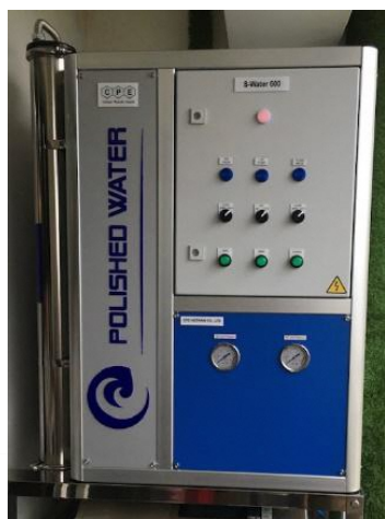
マンション浄水システム
