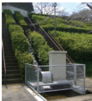
■鏡坂小水力発電設備
