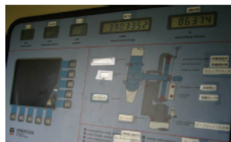
■風車発電制御盤
