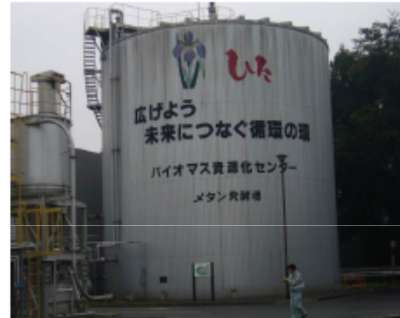
■メタン発酵槽
