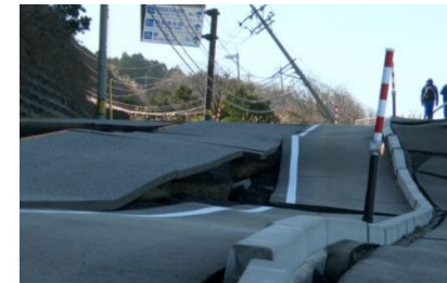
国道249号道の駅千枚田付近 (輪島市)
