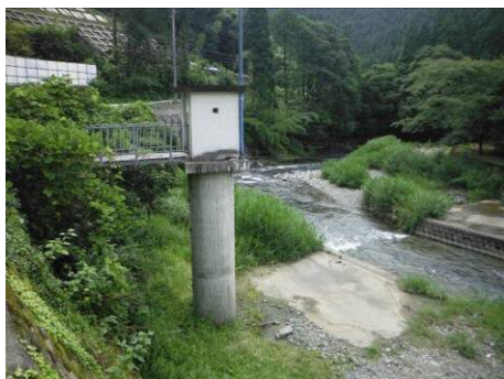
写真 4.4 河川に設置された水位観測所 (テレメーター)
