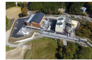
地熱発電事業：大岳発電所
