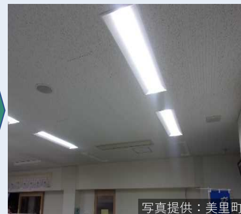
<蓄電池使用時>
