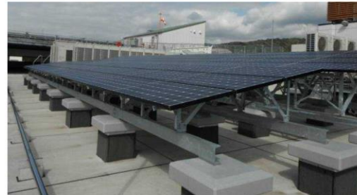
図2: 第二病棟の屋上に設置した太陽光発電設備
