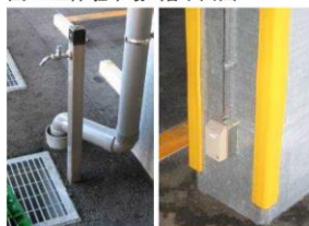
図3: 給水栓・非常用コンセント
