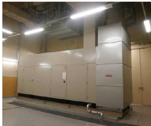
図2:空冷式の非常用発電機(1,600kW)
