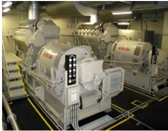
自家発電設備
