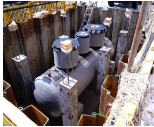
埋設重油タンク
