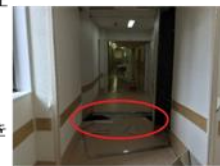
渡り廊下の被害状況
