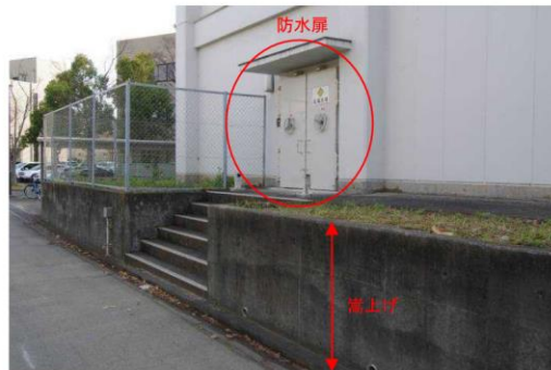
図4: 特高変電所の嵩上げと出入口の防水扉
