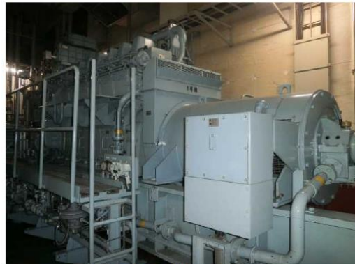
図3:水冷式の常用発電機(1,050kW)
