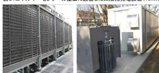
図4:吸収式冷凍機
