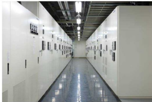
図3: 上階化した電気室(病棟診療棟4階)
