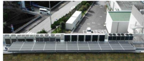
図3: 第二病棟の屋上に設置した太陽光発電設備
