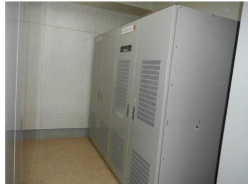
図4: 救急部門に自立運転で電源供給できる蓄電池設備
