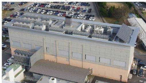
図3:エネルギーセンターの屋上に設置した太陽光発電設備(10kW)
