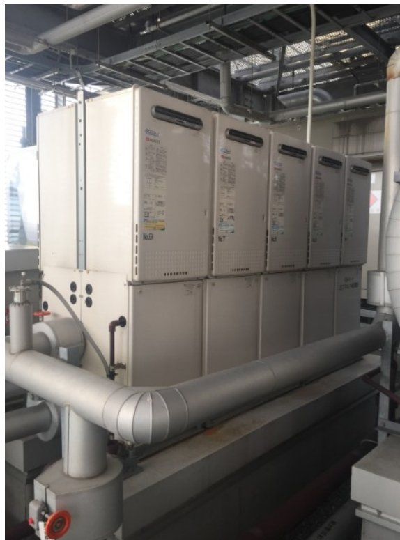
マルチ給湯器 50号×10台
