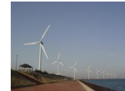
風力発電設備
