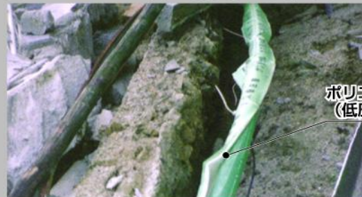
▲地面に露出しても破壊のなかったポリエチレン管(低圧導管)(神戸市東灘区)
