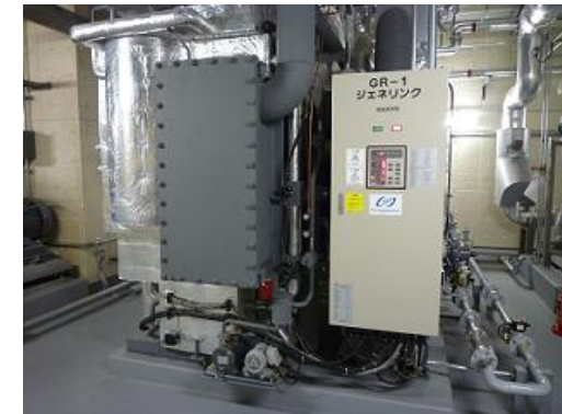
排熱投入型ガス冷温水機 300RT×2 (ジェネリンク)
