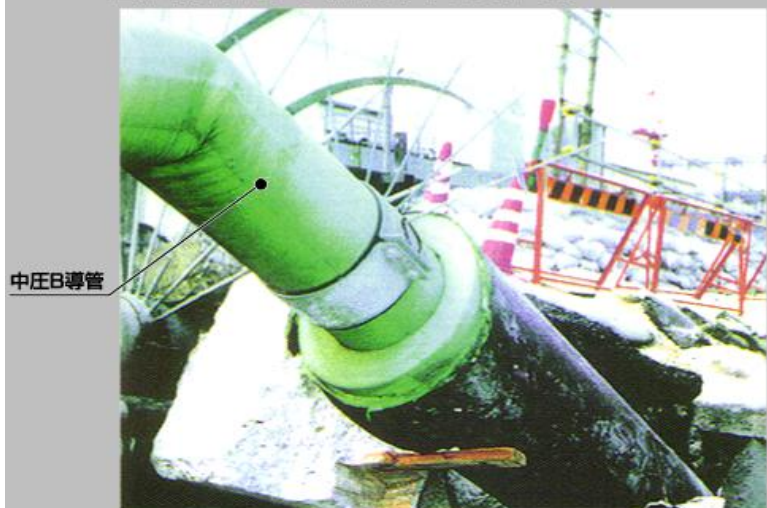
▲湾曲してもガス漏れのなかった中圧B導管(神戸市長田区)
