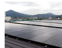
太陽光発電設備
