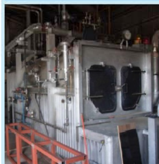
木質バイオマス発電
