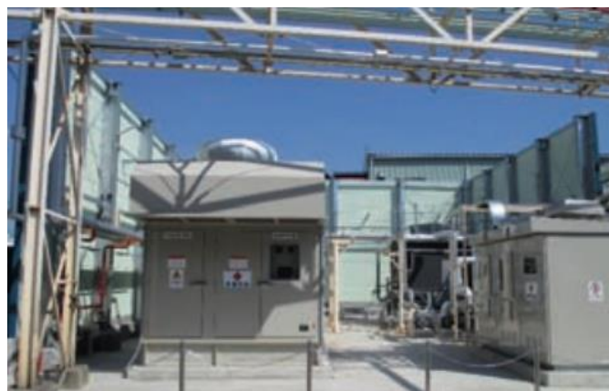
播磨工場 815kWガスエンジン
