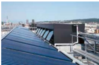
太陽光集熱 パネル (最大回収 熱量50kW)
