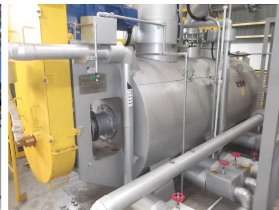
播磨工場 真空汚泥乾燥機
