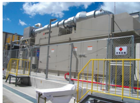
淀川工場 815kWガスエンジン
