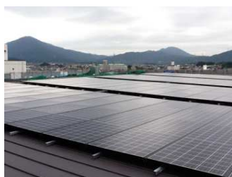
太陽光発電設備
