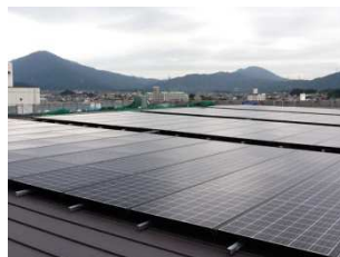
太陽光発電設備
