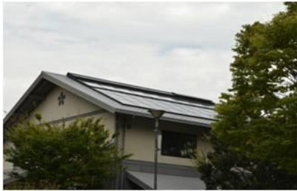
太陽光パネル
