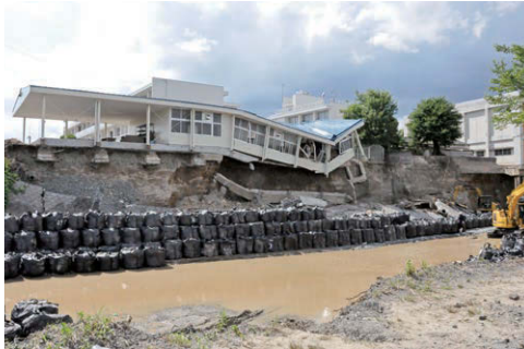
土砂くずれによる建物の倒壊
