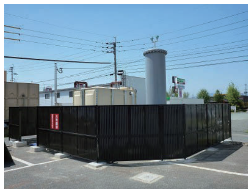
可燃性天然ガス分離設備等の様子
