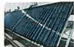
太陽熱利用パネル
