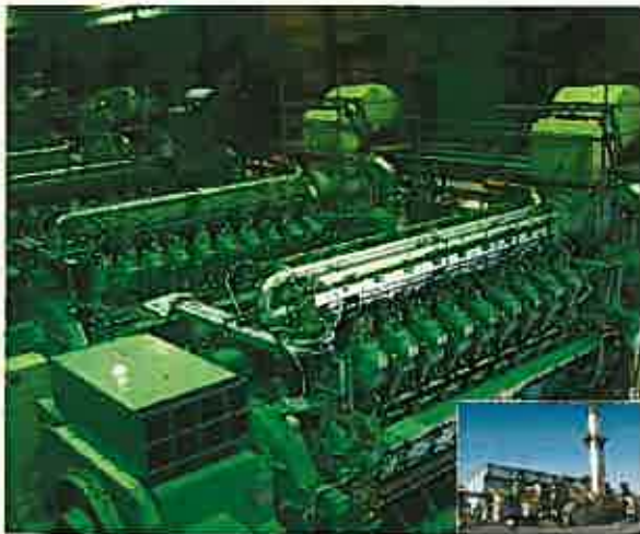
天然ガスを利用した東田地区の基幹電力「東田コジェネ(33,000kW)」
