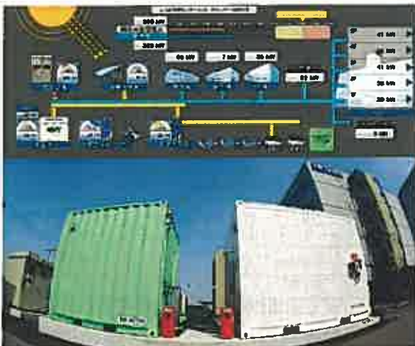
上: 日鉄エレックスのBEMSによるエネルギー需給状況 下: 左40kW・右50kWの大型蓄電池
