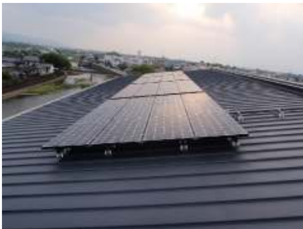
太陽光発電システム（10kW）
