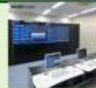
北九州スマートコミュニティ推進事業 CEMS(地域エネルギーマネジメントシステム)
