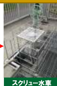
小水力発電 設置場所 (塩素混和池)
