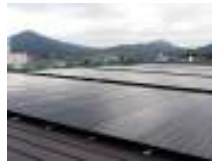
太陽光発電設備
