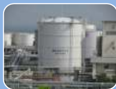
消化ガスタンク
