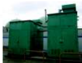
水素製造装置
