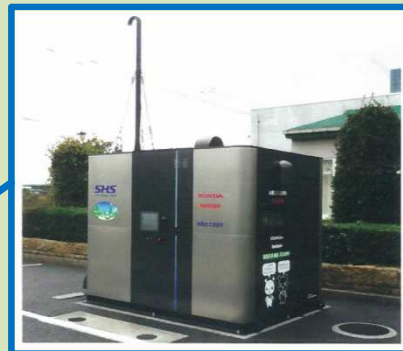
スマート水素ステーション (SHS)
