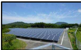
神在太陽光発電所(1MW)
