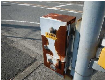
腐食した信号制御機
