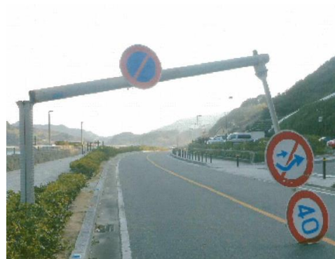
倒壊した大型標識柱
