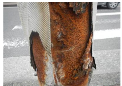
腐食した信号柱
