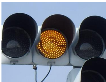
LED 素子の劣化による欠損
