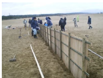
木杭を1m間隔に打設し、高さ1m程度の竹柵を延長約20mにわたり設置しました。
