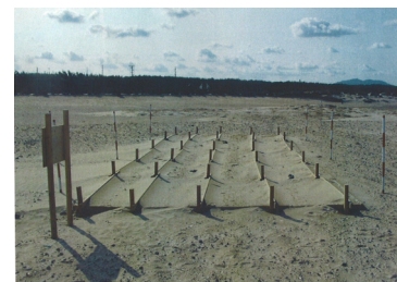
(設置後1ヶ月) 畳部分の砂は安定しているようです。時期をみて、浜辺の植物の移植等を検討します
