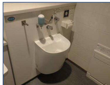
▲オストメイト対応設備
