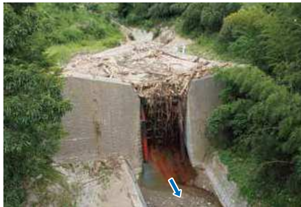
【写真】流木・土砂の捕捉状況(烏山谷川)
