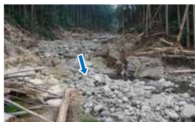
写真② 土砂堆積状況
