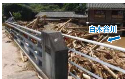
【写真】流木による河道閉塞 (前田橋 朝倉市黒川池田)
