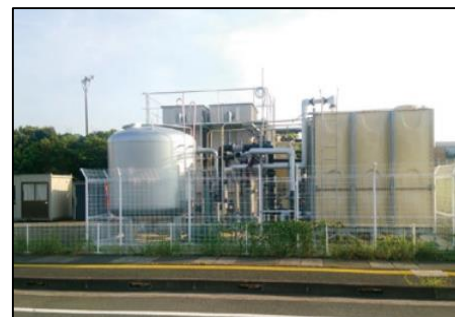
当社施工のBCP水処理設備
