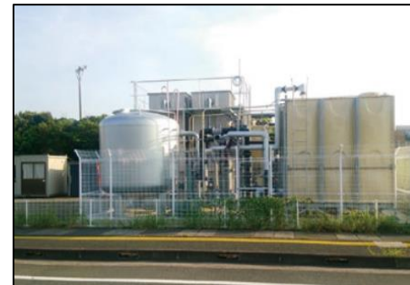
当社施工のBCP水処理設備
