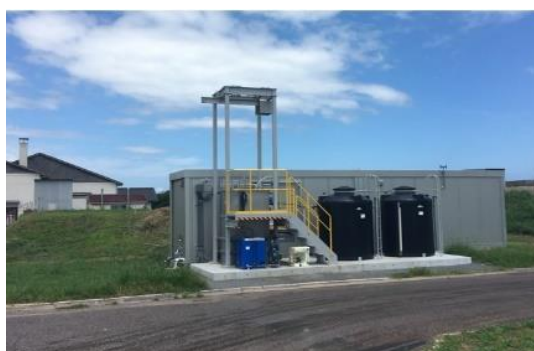
液肥濃縮施設
