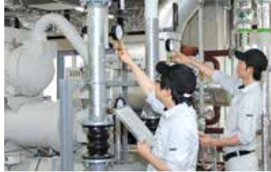
空調設備運転実習
