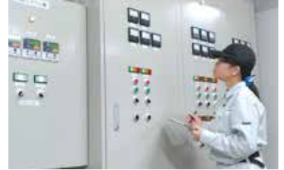
空調設備運転実習
