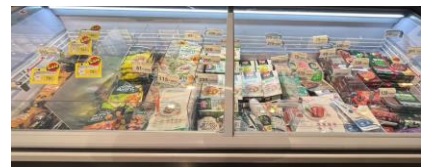
【大手スーパーの冷凍ケース】
