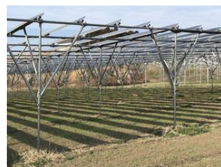
（写真 1）ソーラーシェアリング
