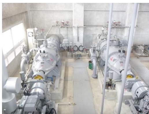
[ 排水機場内部 ]
