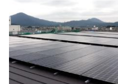
太陽光発電設備
