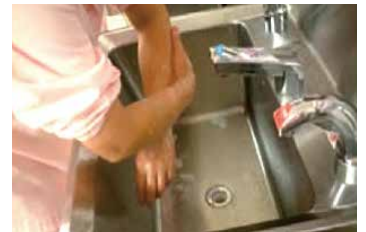
給食調理場の手洗い設備
