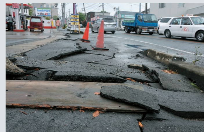
震源地に近くにつれアスファルトのひびや割れが目立ち始める（益城町）
